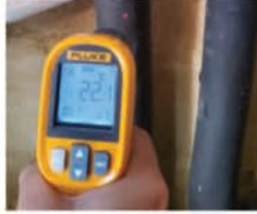
Yalıtımlı su borusu
